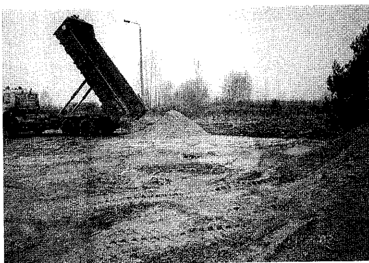
Bild 48 Anfuhr Füllboden für die Restverfüllung der Tankgrube, der Baugrube des Tankstellengebäudes und der Tankinseln
