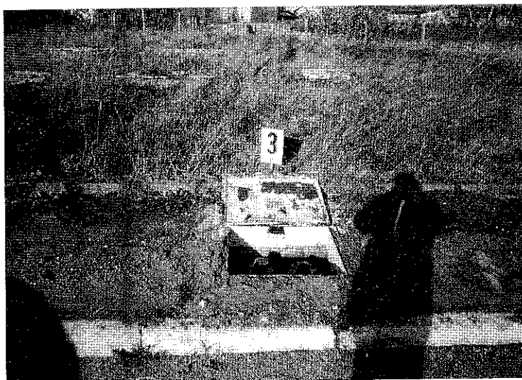
Bild 9 Befüll- bzw. Verteilerschacht 3; baugleich mit Schacht 2; im Bildhintergrund Domschächte der Erdtanks; rechts Domschacht Motorenöltank (6,7 m 3 Größe)
