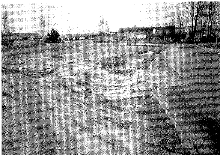
Bild 53 Zustand der Grabenböschung nach Rückbau der Zufahrt zum Gelände der ehemaligen Tankstelle
